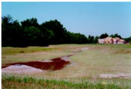
Riser Outlet Pipe
